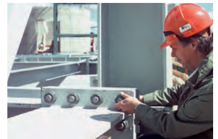
Göran Alpsten kontrollerar högt förspända M36-skruvar i det stabiliserande fackverkets ändplåtsförband. Då förbanden, det vill säga skruvar och muttrar, ej höll måttet för brott-hållfasthet fick de bytas ut.
